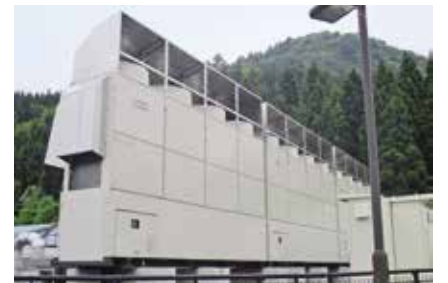
東蒲の里みかわ園 室外機
