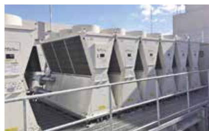
空冷ヒートポンプ(屋上)
