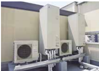
エコキュート設備
