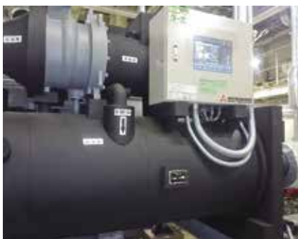
ターボ冷凍機
