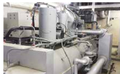
ターボ冷凍機
