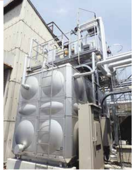
導入システム外観
