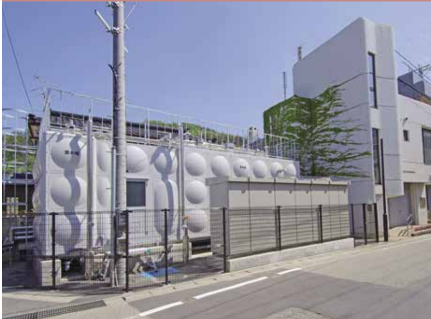
集中給湯設備外観
