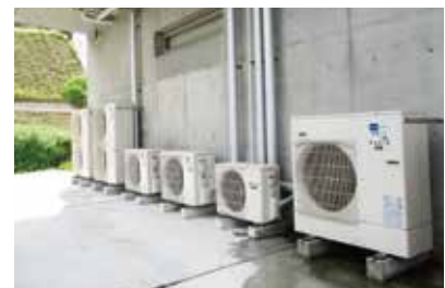
電気式ヒートポンプエアコン室外機
