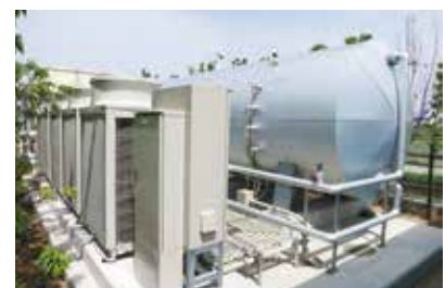
業務用エコキュート室外機と貯湯槽
