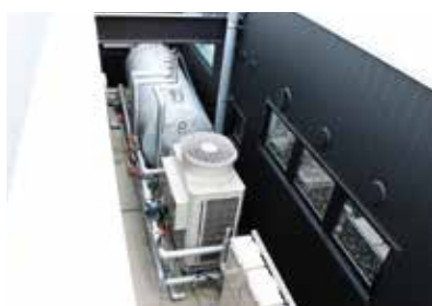
業務用エコキュートの室外機と貯湯槽
