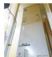
業務用エコキュート貯湯タンク
