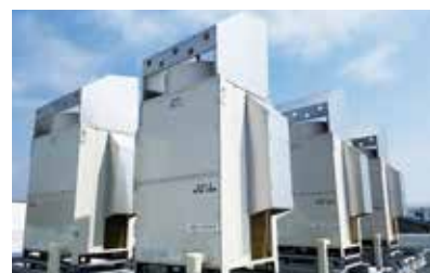
ビル用マルチエアコン室外機
