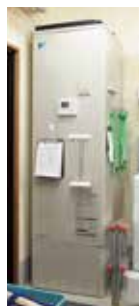
業務用エコキュート 貯湯タンク
