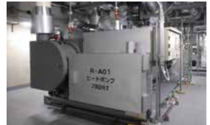
西プラント ターボヒートポンプ
