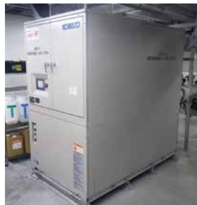
排熱回収ヒートポンプ
