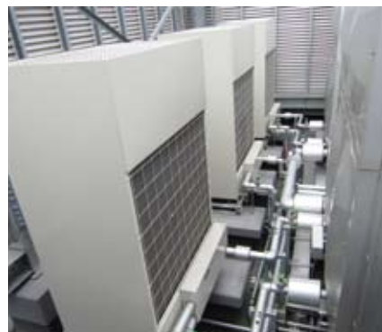
ヒートポンプ給湯機
