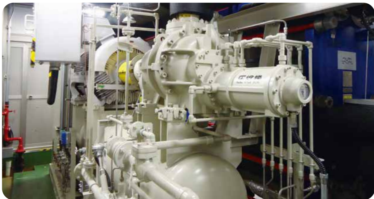
高効率アンモニアインバータ冷凍機
