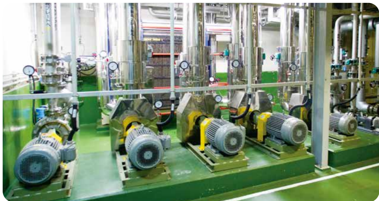
新熱回収システムおよび冷水製造システム
