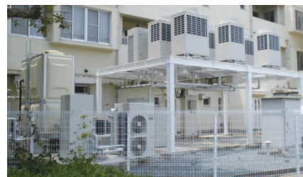
あゆみの里B棟 室外機
