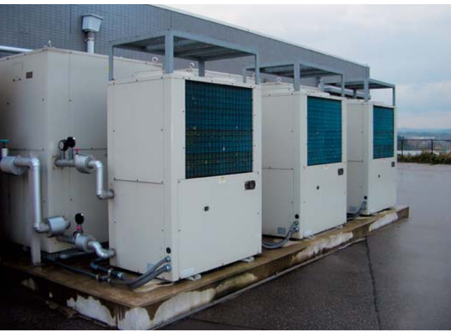
安定したお湯を提供するエコキュート
