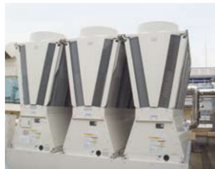
空気熱源ヒートポンプチャラー
