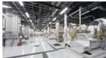
水蓄熱式空調システム(熱源機械室)
