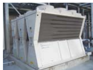
空気熱源ヒートポンプ
