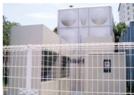
夜間蓄熱用エコキュート (既設)
