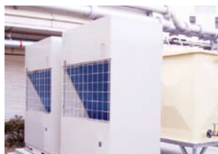
循環加熱用エコキュート (新設)
