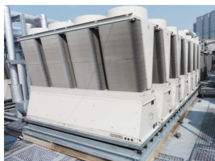
空気熱源ヒートポンプチャラー
