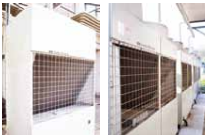
左)業務用エコキュート(密閉対応) 40kW×5台[三菱電機]
