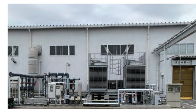
ヒートポンプチラー設置状況
