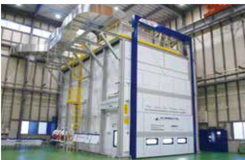
オールヒートポンプ方式を導入した大型塗装ブース全景。
