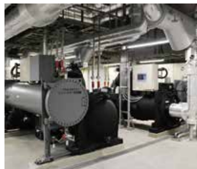
インバーターターボ冷凍機
