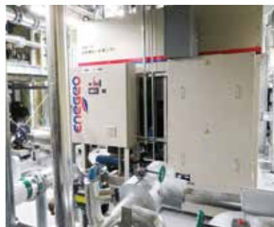
地中熱対応水冷ヒートポンプチャラー
