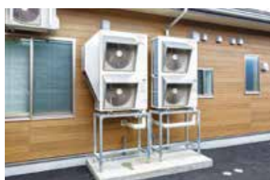
空調機室外機
