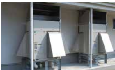
電気式ヒートポンプ(個別分散)室外機
