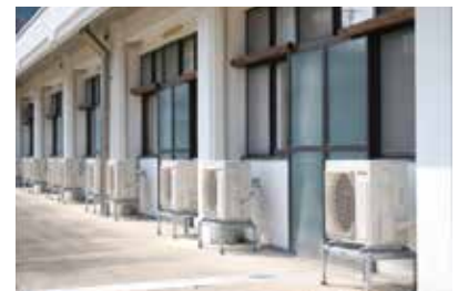
電気式ヒートポンプ(個別分散)室外機
