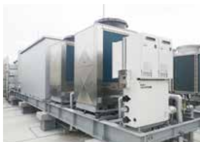
業務用エコキュート(中)と貯湯槽(奥)
