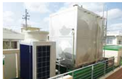
業務用エコキュートと貯湯槽(6m 3 )
