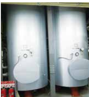
貯湯槽(5,000L×2台)
