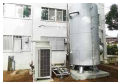
密閉型貯湯槽とヒートポンプユニット
