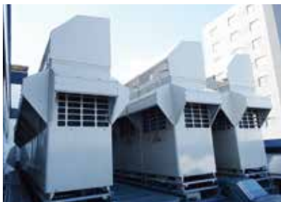
マルチエアコン室外機
