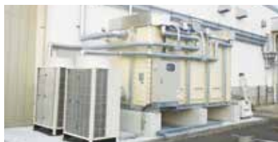
インバータスクロール冷凍機と蓄熱槽
