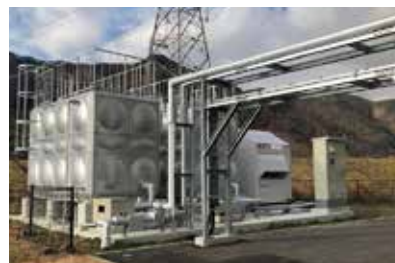
冷温同時ヒートポンプと蓄熱槽
