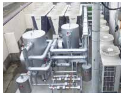
空調システム全景(左奥:空冷ヒートポンプチラー)
