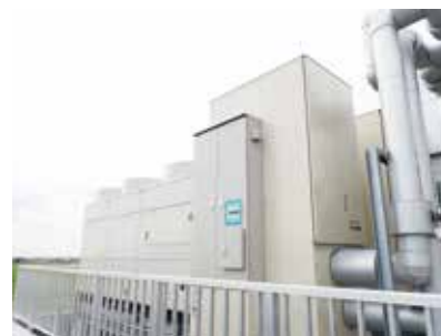
空冷ヒートポンプと冷水タンク
