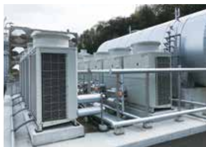
業務用エコキュートと貯湯槽
