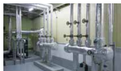
地中熱配管合流箇所
