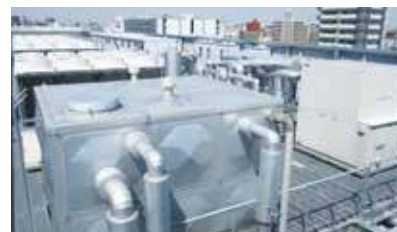
地中熱ヒートポンプチラー(右)と氷蓄熱槽(左)
