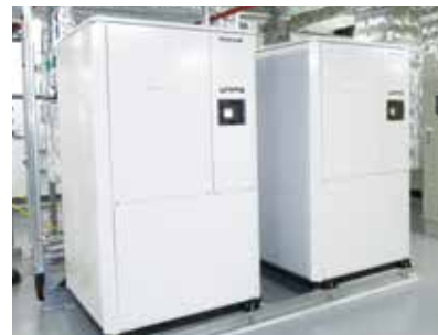
冷温同時ヒートポンプ
