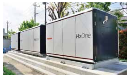
水素エネルギー供給システム外観
