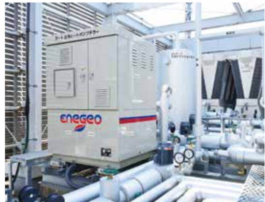
地中熱利用水冷式ヒートポンプ
