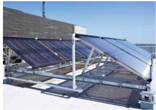
太陽熱集熱パネル
