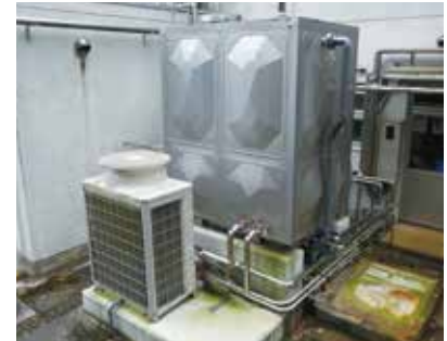
業務用エコキュートと貯湯槽
