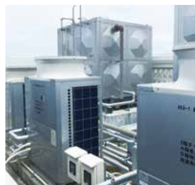
業務用エコキュートと貯湯槽
