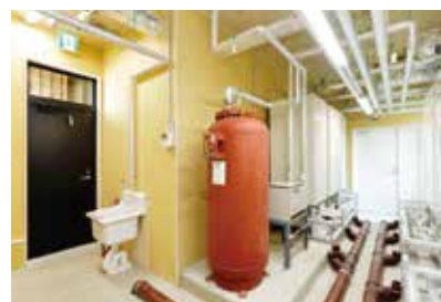
業務用エコキュート貯湯タンク
