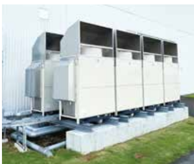
電気式ヒートポンプ
