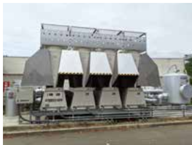
空冷ヒートポンプチャラー
