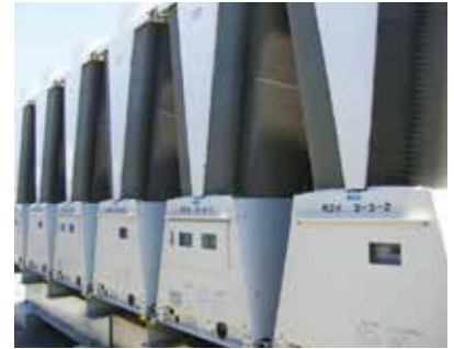
空冷ヒートポンプチャラー
