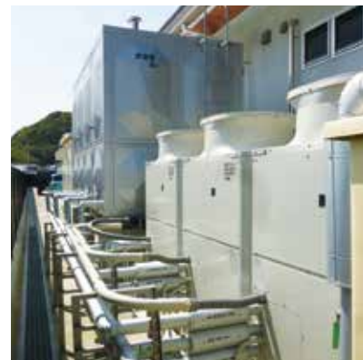
業務用エコキュートと貯湯槽
